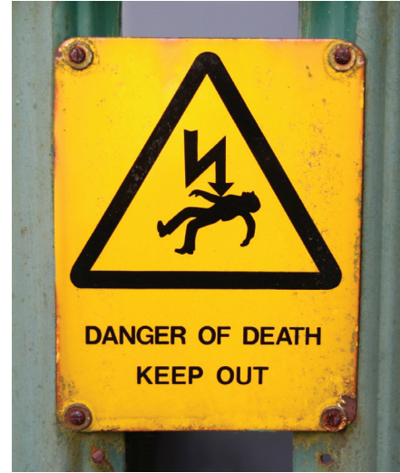
الصورة ١٩-٢ يوجد في محطة الطاقة الكهربائية الفرعية إشارات تحذير من الخطر، كهذه الإشارة التي تُحذّر من الخطر الشديد الناجم عن دخول المحطة الفرعية
