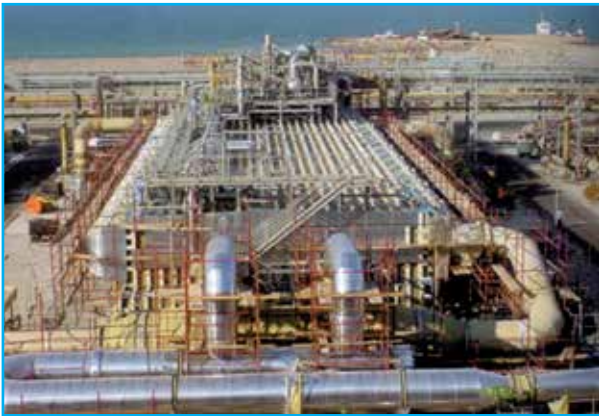
شكل (٢٤) محطة تحلية المياه في بركاء
